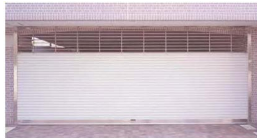
排煙シャッター
